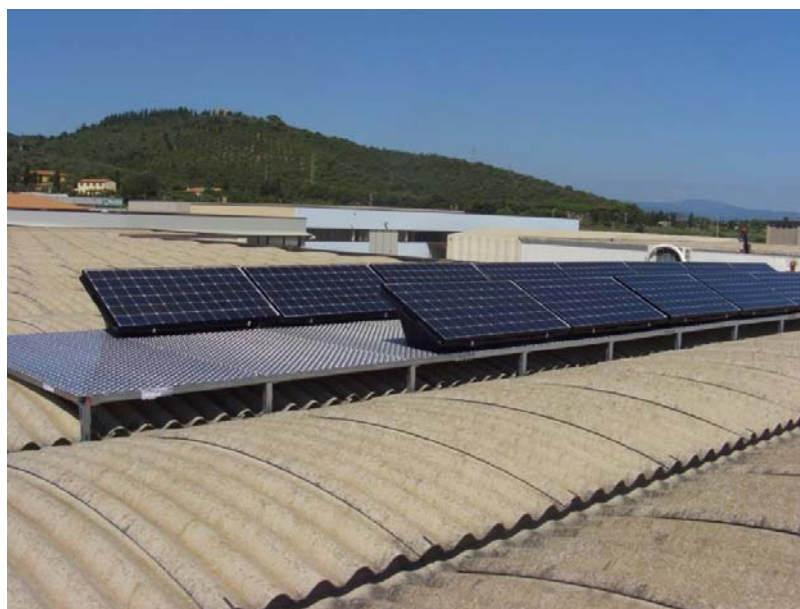
Figura 16 - Esempio di installazione non idonea alla classificazione dell'impianto fotovoltaico nella categoria "su edifici" – Motivazione: i moduli fotovoltaici non sono appoggiati alla superficie di copertura.
