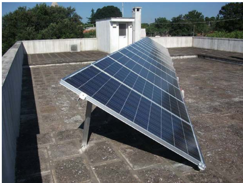
Figura 4 – Esempio di installazione idonea alla classificazione dell’impianto fotovoltaico nella categoria “su edifici” in caso di presenza di una balaustra perimetrale
